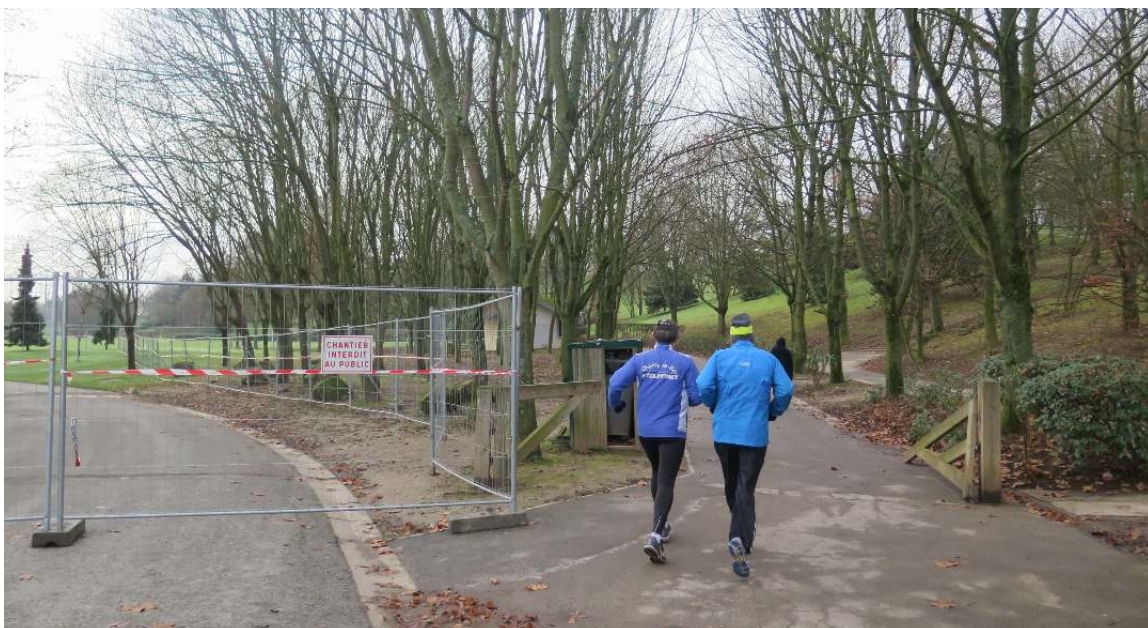
Créteil, hier. Un chantier vient de démarrer sur l'île de loisirs à Créteil pour refaire l'allée centrale qui dessert la maison de la nature et mène jusqu'au restaurant et l'école de voile. (LP/A.V.)
