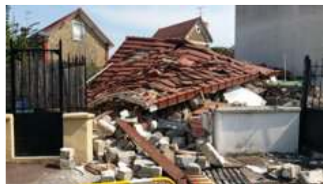
Pavillons-sous-Bois, vendredi. Il ne reste qu'un tas de ruines du pavillon soufflé par une violente explosion, probablement due au gaz. (LP/T.P.)
