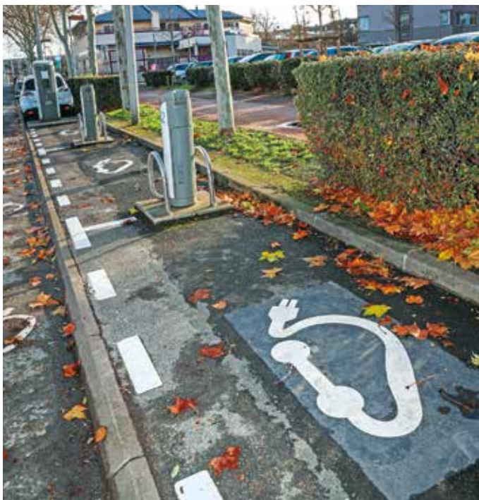
Une station de recharge électrique remise en service, boulevard Jean-Baptiste Oudry.
